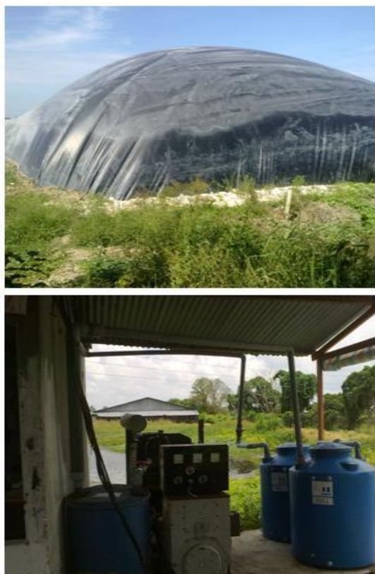
Hình 2.4. Hàm Biogas xử lý nước thải và chạy máy phát điện tại cơ sở chăn nuôi
